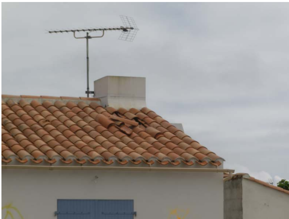
Figure 6. À la Faute-sur-Mer, les services de secours ont dû accéder aux habitations en soulevant les tuiles faute d'accès par des ouvrants de toit.
