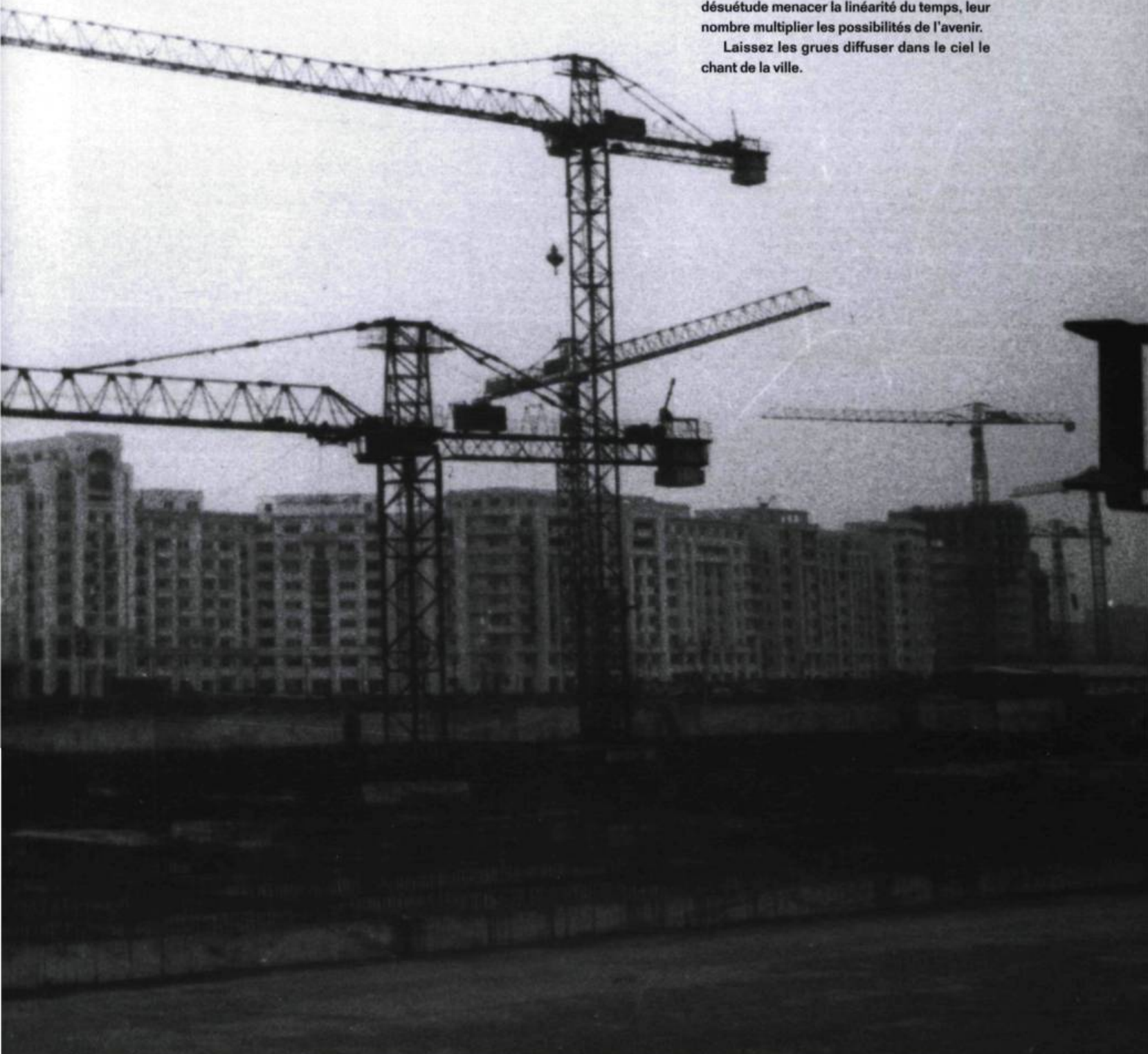
[photos] Chantiers en plein cœur de Bucarest, automne 1996. Ils sont dans cet état depuis la Révolution, soit depuis 1989. Ph. : Juliana MAXIM
