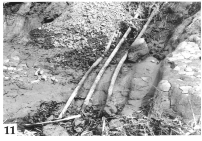
FIGURE 11. Fils métalliques exposés par suite de l'érosion de la falaise morte au front de la terrasse de 8 m (11-5-91).
