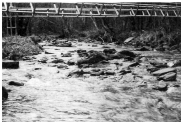
FIGURE 4. Vue du contact entre la zone d'affouillement et le banc d'accumulation (en regardant vers l'amont).
