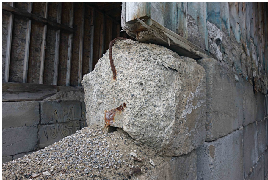
Figure 14. Bloc de béton en décomposition à l'un des hangars de stockage de sel, étape de la promenade. (Source : H. Sturm. Cette photo figure dans un livret que nous avons donné à chaque participant de la promenade).
