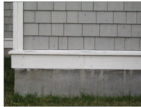
Une transition marquée entre la fondation et le bas du mur est nécessaire pour souligner l'assise de ce dernier.
