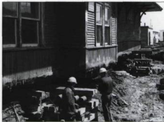
La gare soulevée sur poutres d'acier montrant le mauvais état des fondations. (Archives de la Société de la gare, Acton Vale).
