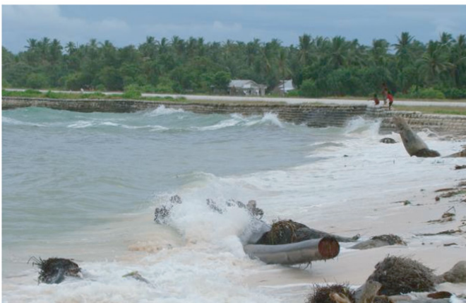
E. Côte océanique de Bonriki (Tarawa Sud, Kiribati), au droit de la piste d'atterrissage : l'érosion n'est pas contenue par le mur de protection édifié par les autorités (cliché : V. Duvat, 2010).
