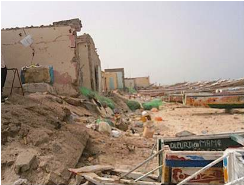
Figure 7. Maisons détruites par l'érosion côtière (Saint-Louis).
