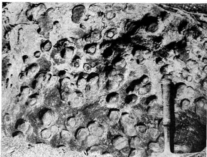
Photo 13 Type de corrosion sur bloc de grès de bas estran, à Sainte-Flavie; grands alvéoles aux formes émoussées affectant une couche plus calcaire et rappelant les logettes produites par les oursins.
