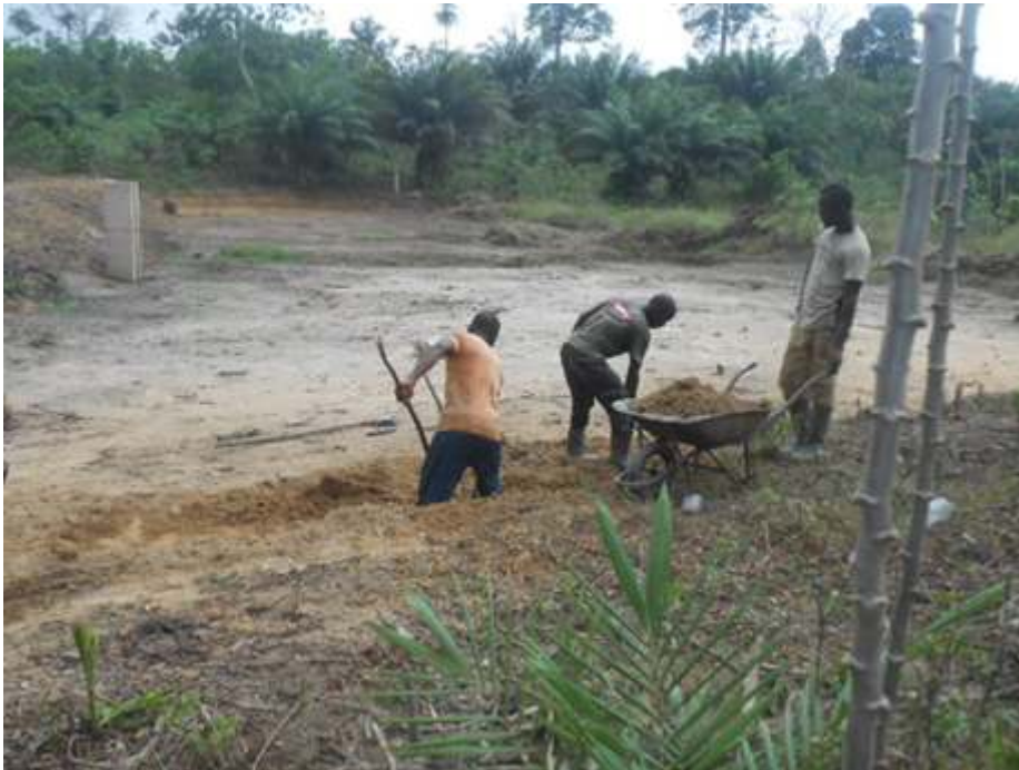
Figure 3a. Différents emplacements des sites piscicoles. Etang en construction au sein d'une plantation - Méagui / C.-O.
