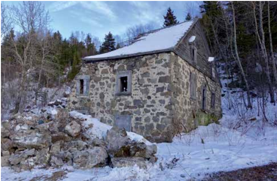
Vacant depuis plusieurs années, le moulin du Petit-Sault à L'Isle-Verte s'est fortement détérioré. En novembre 2018, une partie du bâtiment menaçant de s'effondrer a dû être démolie.
