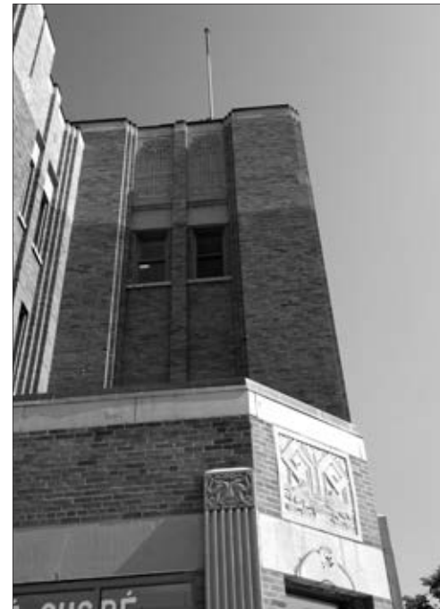
L'extérieur du Marché Saint-Jacques a été bien conservé, notamment ses bas-reliefs, mais les briques posées en haut des murs en 1997 tranchent avec les briques d'origine.
