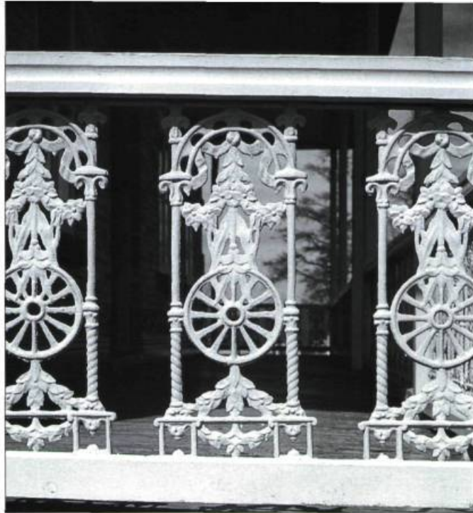
Balustre de garde-corps en fonte présentant un motif géométrique et différents motifs floraux.
