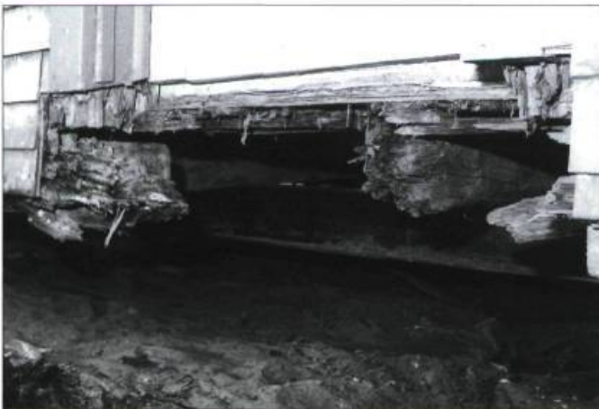
Une fois la bâtisse levée, certains endroits peuvent montrer un état de pourriture avancée. Ici, le seuil de la porte arrière et la portion correspondante de l'assise de bois se sont détachés, laissant apparaître la pourriture.
