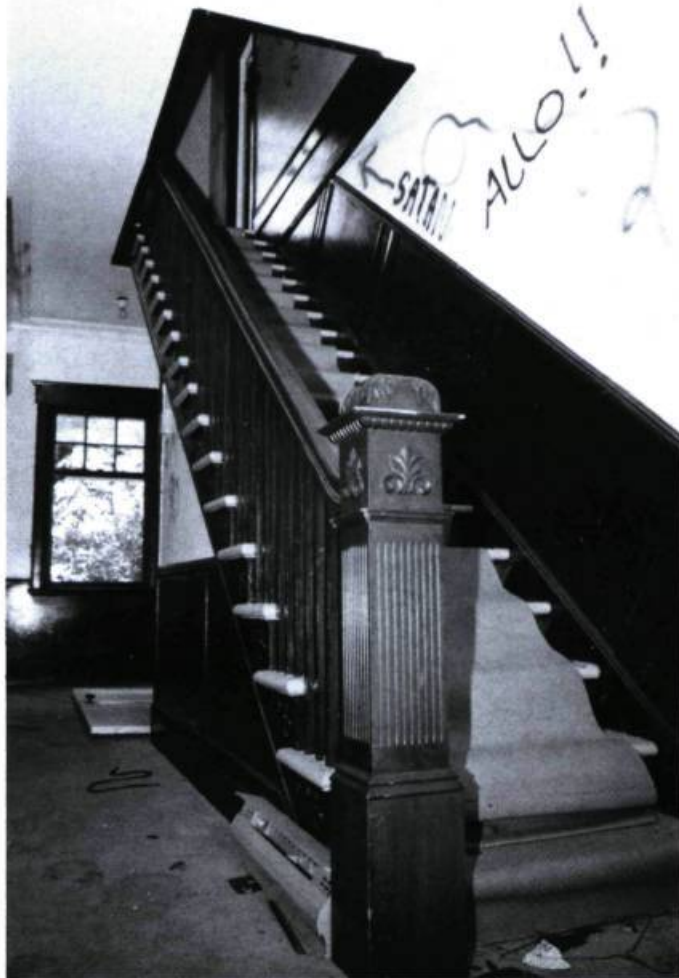
L'escalier du corps principal de la maison Barbeau, à Saint-Constant, en août 1990. Photo: Yves Bellefleur.
