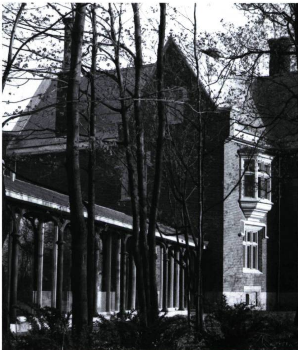
L'état du manoir réservait certaines surprises. Près du quart de la maçonnerie présentait des déficiences et les boiseries étaient en grande partie à refaire. (photo: P. Trépanier)
