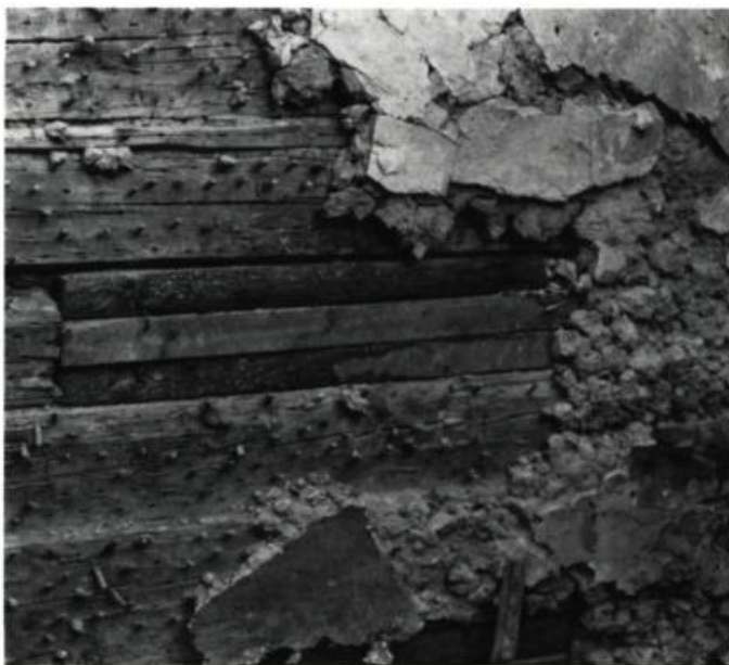
2. «Picotis» de chevilles de bois servant à l'accrochage du crépi. (photo: R. Bilodeau)
