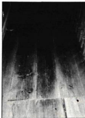
11. Exemple de plancher sablé et «varathané» qui laisse voir l'usure du temps et les traces de l'occupation du bâtiment. (photo: F. Varin)
