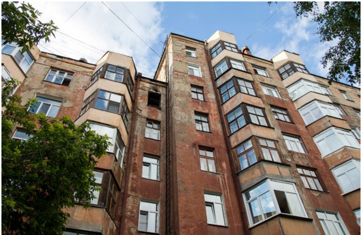
Le bâtiment 14 de la cité des tchékistes, en état de délabrement. Photo : Manon Masset
